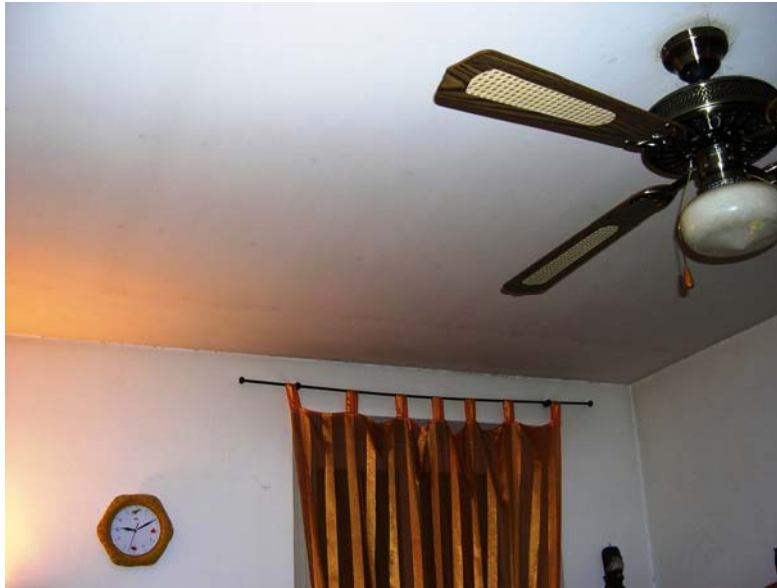
Fig. 5- Controsoffitto: i punti di contatto fra pannelli in cartongesso e struttura metallica portante sono anneriti.
