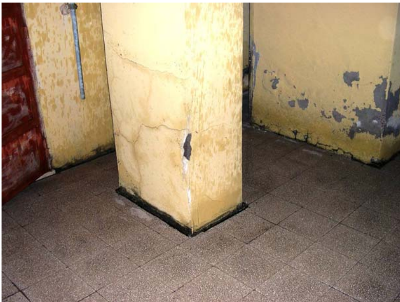
Fig. 8- L'intonaco della canna fumaria è lesionato in più punti e mancante in altri. Manca lo zoccolo battiscopa
